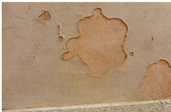
Figure 9 : Enduit non adhérent à décaper
