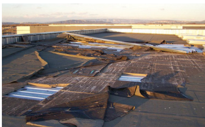
Figure 10 : Sous-dimensionnement des fixations de la membrane d'étanchéité au regard de l'exposition du site au vent (soulèvement de 250 à 300 m 2 d'étanchéité ainsi qu'arrachement de 3 bacs métalliques supportant le complexe)
