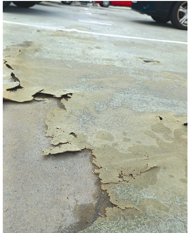
Figure 23 : Revêtement dégradé par la circulation des véhicules.
