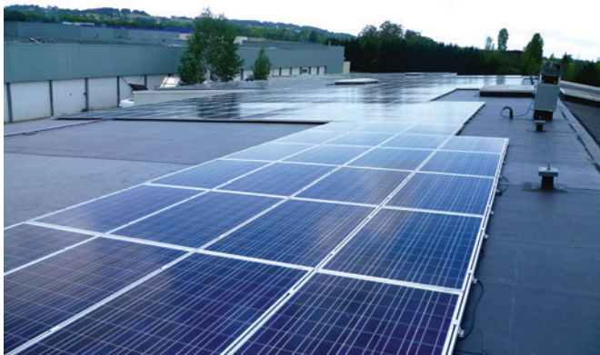
Figure 3 : Toiture photovoltaïque – système avec modules surimposés
