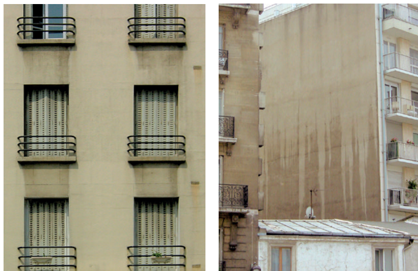
Figure 2 : Salissures dues à la pollution atmosphérique
