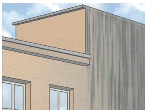
Figure 30 : Coulures sur la façade
