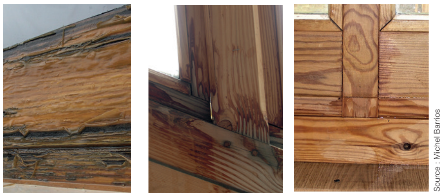
Figure 1 : Pourrissement sur menuiserie en bois non entretenue entraînant sa déformation et des infiltrations d'eau
