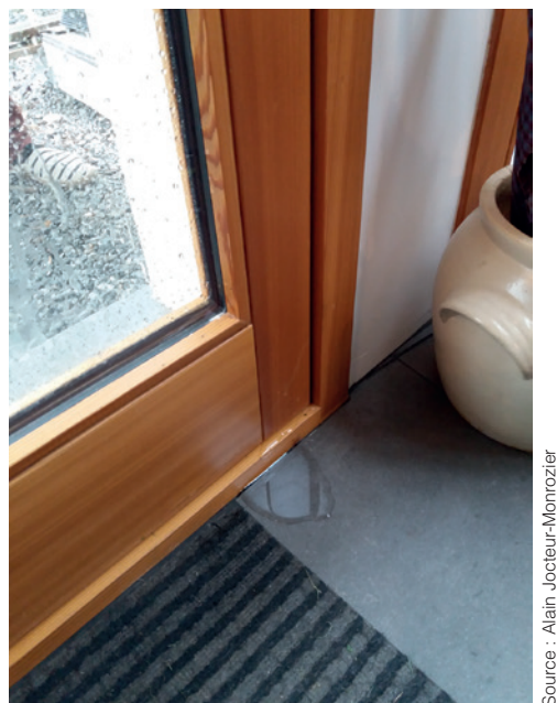
Figure 2 : Infiltration d'eau ouvrant-dormant
