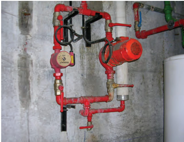
Figure 3 : Corrosion sur bouclage ECS
