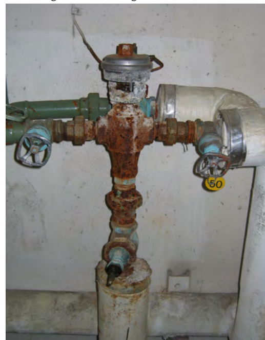
Figure 6 : Corrosion/entartrage sur vanne de régulation
