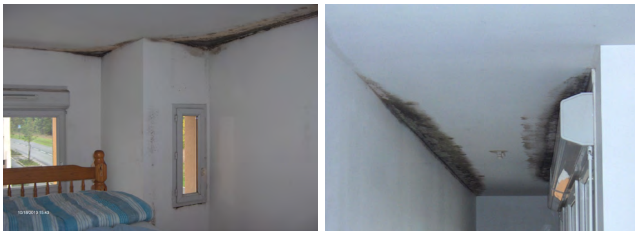
Figure 9 : Conséquences d'un manque de ventilation et de ponts thermiques
