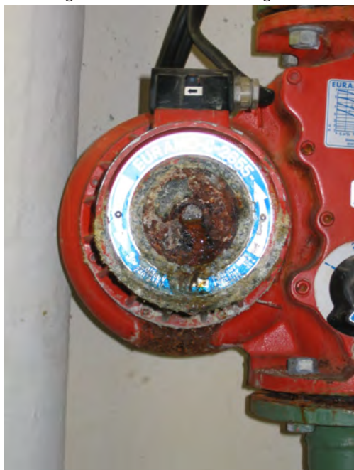
Figure 5 : Corrosion sur moteur pompe
