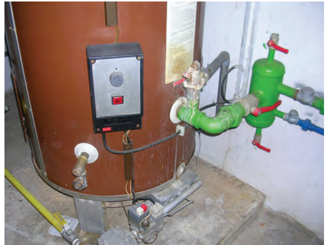
Figure 4 : Entartrage bloc de sécurité
