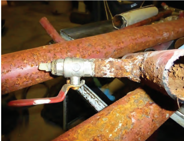
Figure 1 : Corrosion réseau eau glacée
