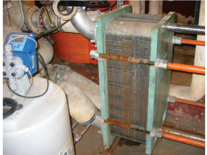
Figure 2 : Corrosion et entartrage échangeur à plaques sur réseau ECS
