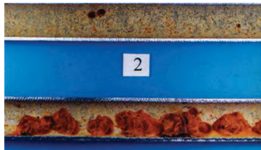
Figure 8 : Exemple de tronçon de canalisation en acier galvanisé placée horizontalement dans l'installation (après ouverture). La génératrice supérieure est recouverte d'un dépôt continu et adhérent. La génératrice inférieure présente des pustules d'oxydes foisonnantes. Toutefois, on ne peut, par simple observation visuelle, constater la profondeur des corrosions et leur évolution.
