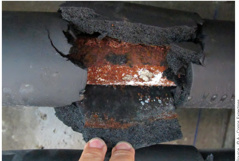
Figure 2 : Corrosion sous isolation sur un circuit d'eau glacée, due à un manque de continuité de l'isolant et du pare vapeur
