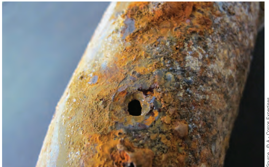
Figure 3 : Détail de la perforation
