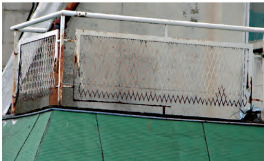
Figure 5 : Un autre garde-corps de la même série présente un état de corrosion avancé des éléments de remplissage et des potelets. Il est probable que seul un remplacement pourra conduire à un résultat satisfaisant
