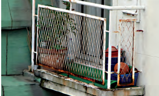
Figure 4 : Garde-corps métallique en acier dont l'élément de remplissage est très dégradé
