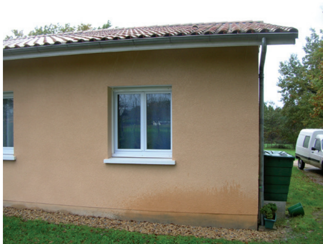
Figure 48 : Les gouttières ne sont pas bien nettoyées et débordent, avec un risque d'humidification localisée dans l'angle.
