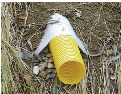
Figure 18 : L'emploi d'un drain agricole d'épandage, totalement perforé TP au sens de la NF P 16-379, pour le captage des eaux de ruissellement est sinistrant. Il devrait être interdit explicitement dans les textes pour les ouvrages de bâtiments.
