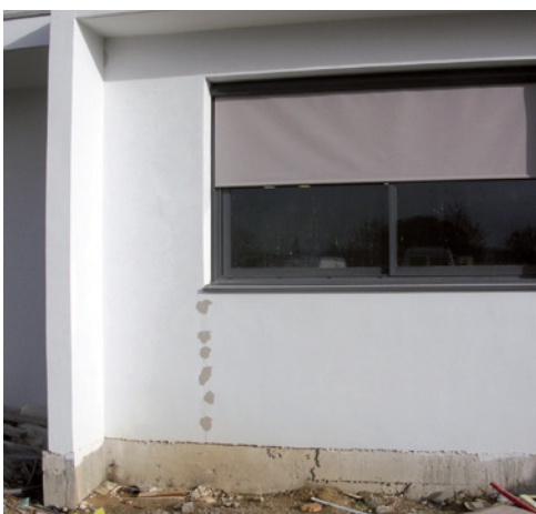
Figure 100 : Ces témoins ont été posés sur la microfissure qui s'est ouverte à la jonction, entre le poteau en béton et l'allège en maçonnerie.
