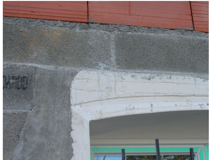
Figure 196 : La variété des matériaux constituant cette façade (blocs béton, briques de terre cuite, rebouchage au mortier, cadre en béton préfabriqué) conduit à s'inquiéter légitimement du comportement final de l'enduit qui viendra recouvrir l'ensemble.
