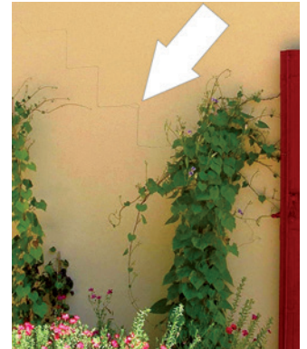
Figure 11 : L'angle de cette maison s'est enfoncé. La fissure qui s'est ouverte suit les joints de la maçonnerie.
