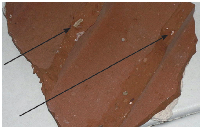
Figure 126 : Les points de chaux visibles dans cette brique ont provoqué l'éclatement de la cloison et l'effondrement partiel d'un plafond. La réhydratation d'un point de chaux est très lente. L'effondrement peut se produire plus de 20 ans après la construction.
