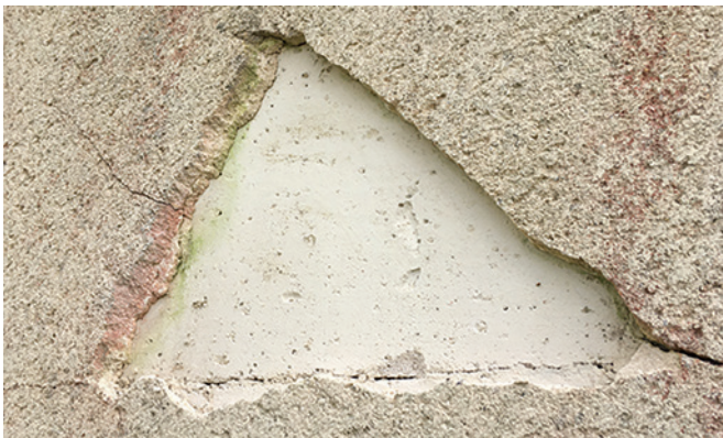
Figure 194 : La fissuration du support peut conduire au décollement de l'enduit et certainement à sa fissuration.
