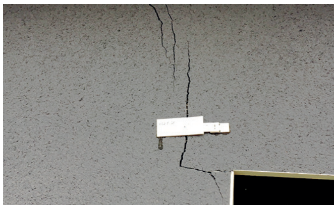
Figure 41 : La fissuration consécutive au tassement suit les contours du linteau
