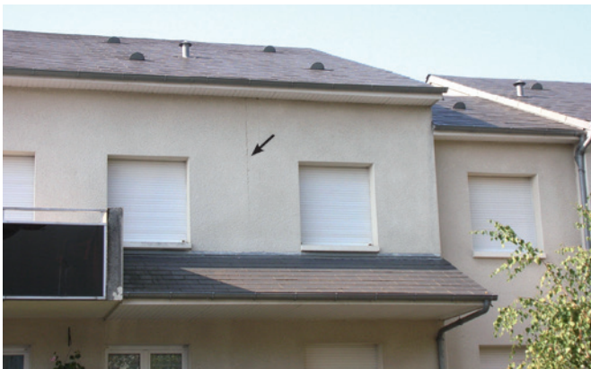
Figure 99 : Jonction voile-maçonnerie. Le refend intérieur de cet immeuble n'a pas été harpé avec les maçonneries de façade. Une fissure dite de retrait s'est ouverte.
