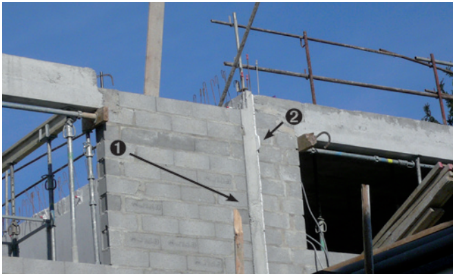
Figure 98 : Le refend béton de cet immeuble en construction vient au contact des maçonneries de façade. En l'absence de harpage, on peut penser qu'une fissure va s'ouvrir à la rencontre entre les deux matériaux.
