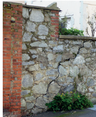
Figure 10 : Seul l'angle de ce mur est bien fondé. Une fissure de cisaillement s'est ouverte.
