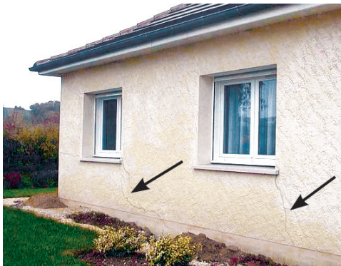
Figure 49 : Des fissures d'allure inclinée à 45° dans les angles des ouvertures : c'est un tassement.
