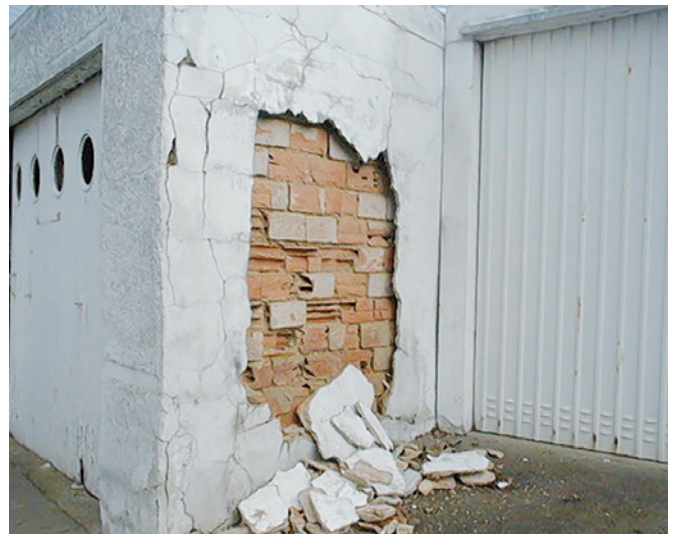
Figure 128 : Les briques ont gonflé en présence d'humidité. L'enduit s'est fissuré puis est tombé au sol. Les briques modernes ne présentent plus ce genre de défaut.
