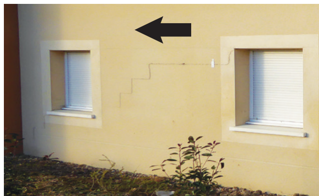
Figure 43 : Ces fissures pourraient conduire à penser qu'elles résultent d'un tassement de l'angle de l'immeuble. Elles font suite en fait à un retrait du plancher séparant les niveaux.
