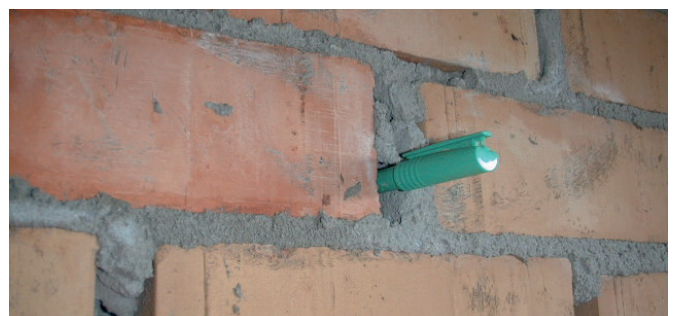
Figure 129 : Un mur dont les joints sont aussi grossiers ne pourra pas être étanche
