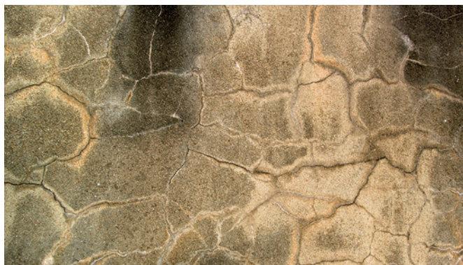
Figure 198 : Fissuration de type faïençage caractéristique. L'enduit trop fortement dosé en ciment a fait du retrait puis s'est fissuré.
