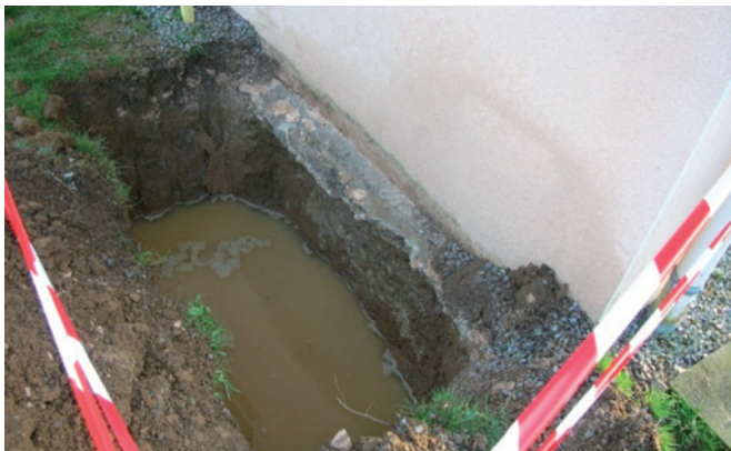
Figure 50 : À l'ouverture de sondages, on constate la présence anormale d'eau dans le sol au-dessus du patin de fondation. La nappe phréatique a pu, lors de sa remontée, altérer la portance du sol.
