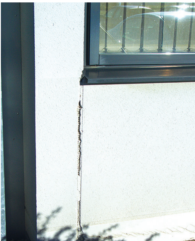
Figure 195 : La pose d'une armature de type treillis à la jonction entre un voile béton et une allège en maçonnerie ne peut donner satisfaction à lui seul.
