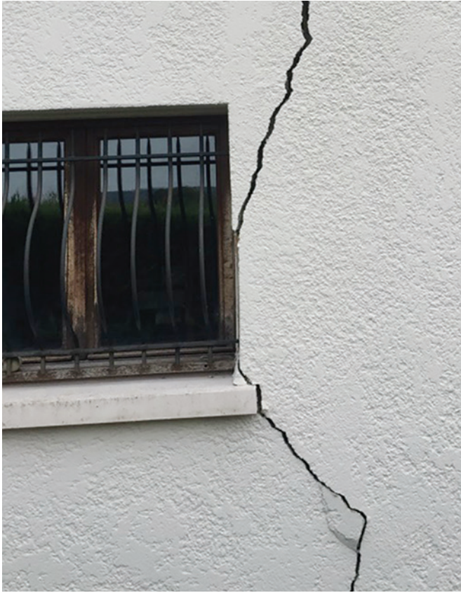
Figure 4 : Le dommage revêt de l'ampleur. Le terme « crevasse » est approprié pour le qualifier.
