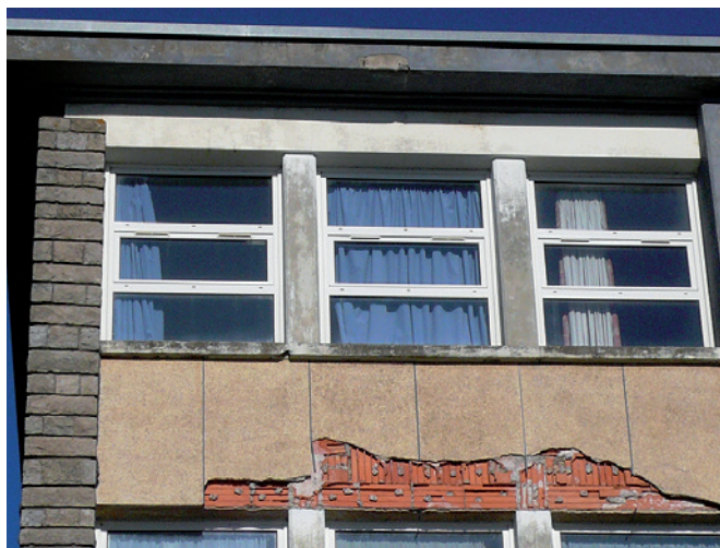
Figure 127 : La rénovation de cette façade dont les briques sont gonflantes va conduire à des travaux lourds. Lors du ravalement d'une façade bâtie en briques, il convient toujours de sonder le support.
