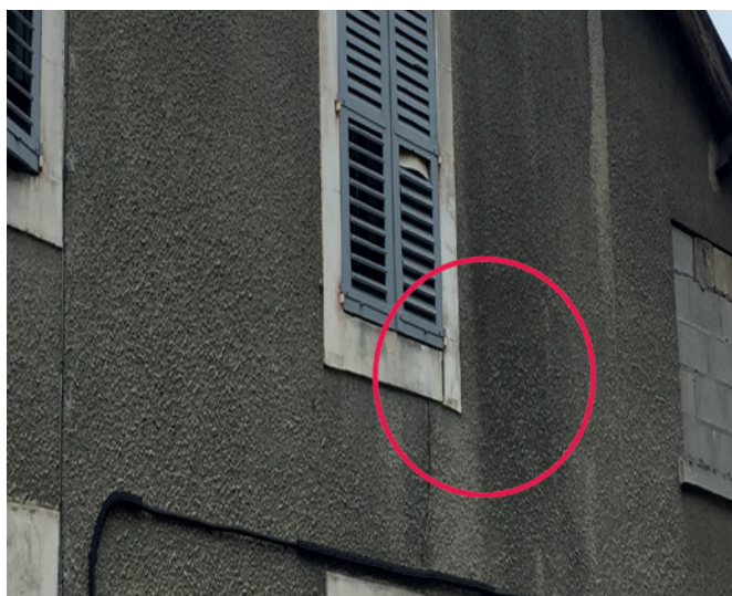
Figure 42 : Dans les constructions anciennes en maçonnerie de qualité sommaire, les fissures suivent les points faibles des murs sans adopter de direction privilégiée
